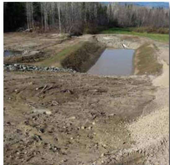
Fig.13 Bassins et vannes à cloison siphôide utilisés dans un autre projet afin de protéger une source d'approvisionnement d'eau potable. (St-Aimé-des-Lac, Charlevoix)
